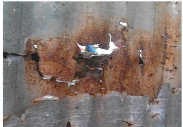
Photo 11 : Toilette porte trouée à Médina Gounass (Guédiawaye) et à Yeumbeul Sud (Pikine)
