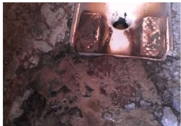
Photo 8 : Toilette zone inondée Médina Gounass
