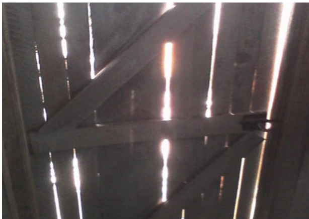
Photo 10 : Toilette porte trouée à Médina Gounass (Guédiawaye) et à Yeumbeul Sud (Pikine)
