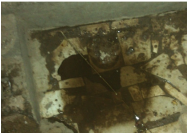
Photo 5 : Toilette zone inondée Wakhinane Nimzat
